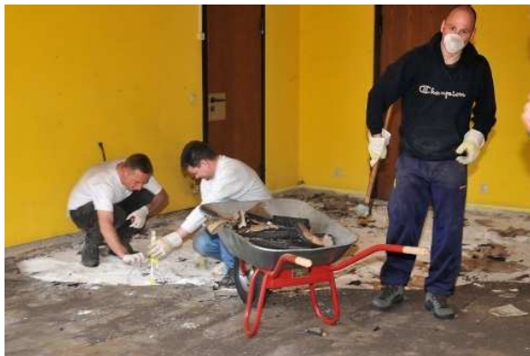
Tatkräftig wird die Sanierung durch die Eltern unterstützt. Bild: Karl-Heinz Rückert, Rundschau
